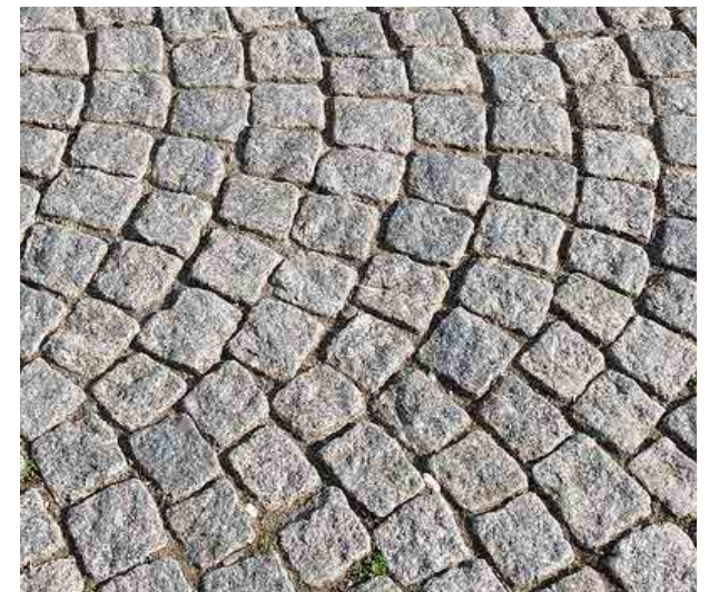
Avvikande markbeläggning och nivåskillnader vid mötesplatsen, där fotgängare och cyklister har företräde.
