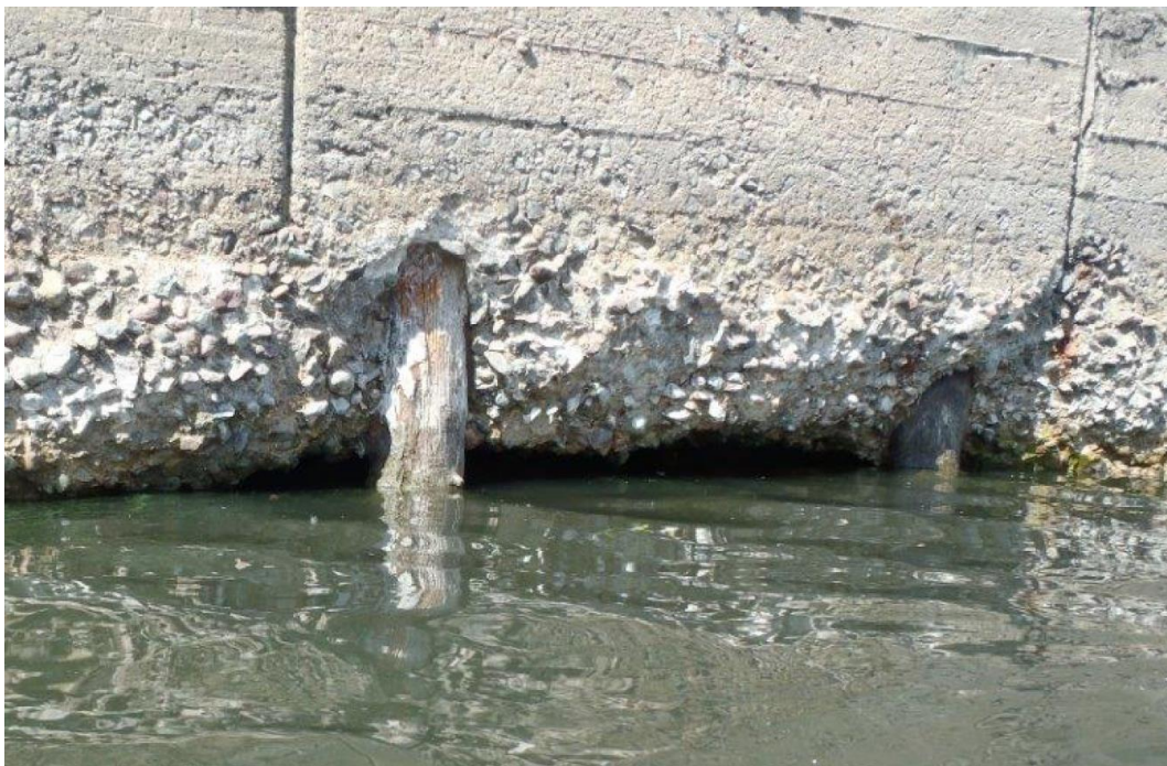
Figur 6.4. Isnötning i nivå med vattenlinjen i sektion 0/115. (BOSTEK 2018-06-07)
