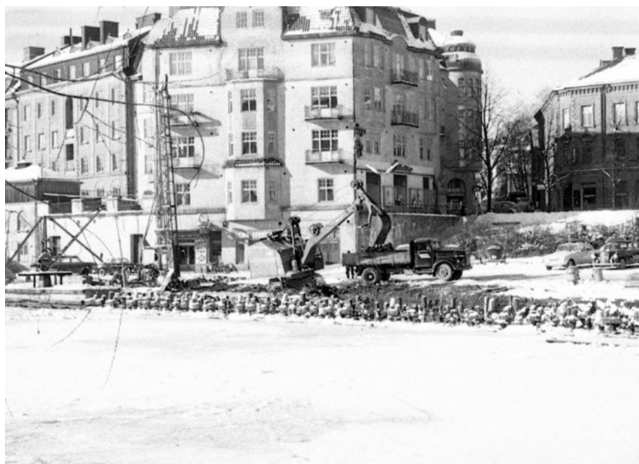
Figur 3.5. Foto från slutet av 1950-talet taget under byggskedet av befintlig kaj vid Marenplan. (Länstidningen Södertälje)
