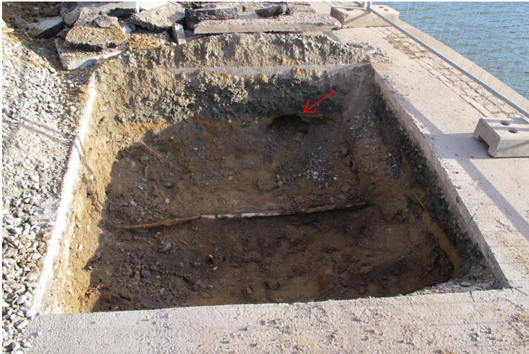
Figur 6.3. Provgrop i sektion 0/025. Observera hålrum i bakkant av provgropen (se röd pil) i ungefär samma läge som tidigare slukhål i figur 6.2. (KFS 2020-04-01)
