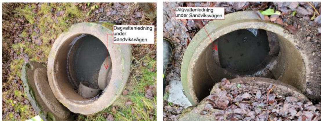
Figur 14. Trafikverkets ledning som sträcker sig under Sandviksvägen. Foton från platsbesök.
