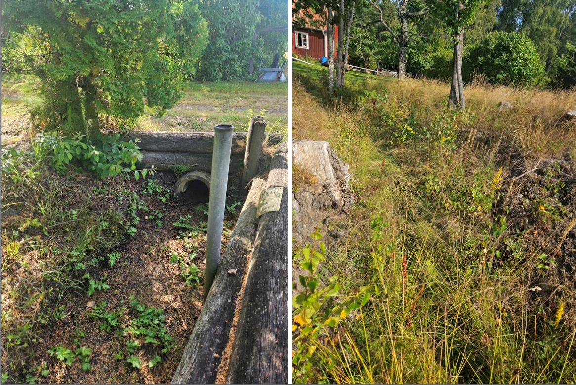
Figur 3:2. Inlopp till dagvattenledning (vänstra bilden) och dike nedströms ledning (högra bilden) som är beläget norr och planområdet och mynnar ut i planområdets norra del
